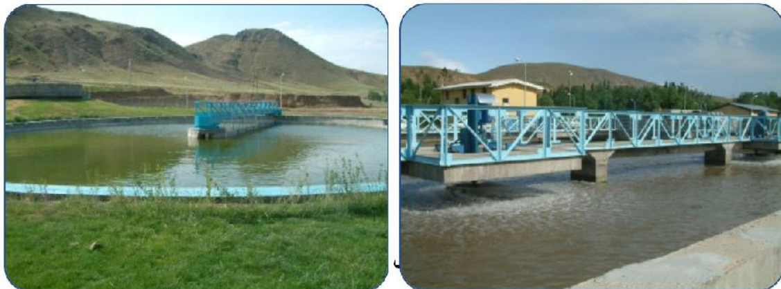
شکل ۲. تصاویری از حوض هوادهی و زلالساز
