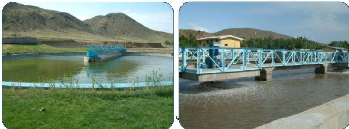
شکل ۲. تصاویری از حوض هوادهی و زلالساز
